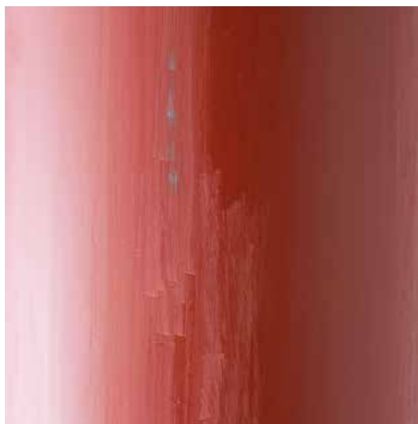
Imagen derecha: la misma operación de raspado, realizada sobre un bajante cubierto con la imprimación TodoTerreno al agua , de Beissier . En este caso, se aprecia que la pintura no se desprende como lo hace en la figura de la izquierda.
