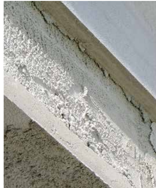
Ejemplo de la zona a consolidar ▲
