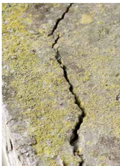
Filtraciones por grietas en el exterior.
