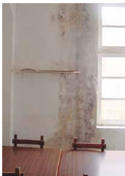
Humedad por capilaridad.
