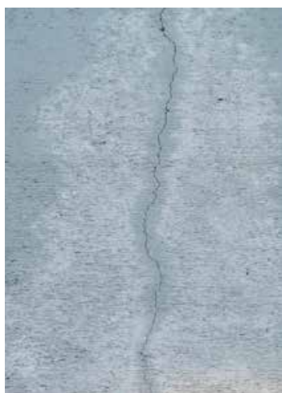
Filtraciones por grietas en el exterior.
