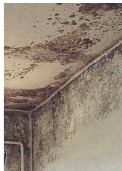
Condensación en paredes frías.
