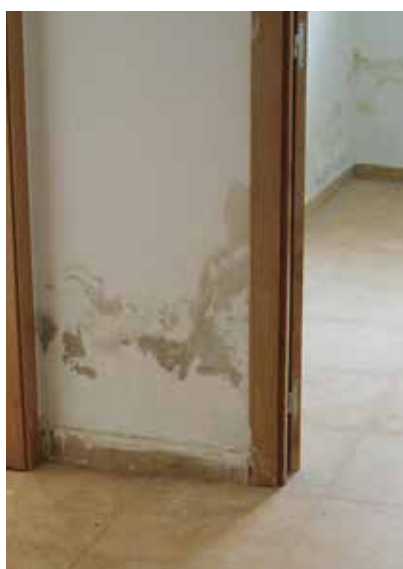
Humedad por capilaridad.
