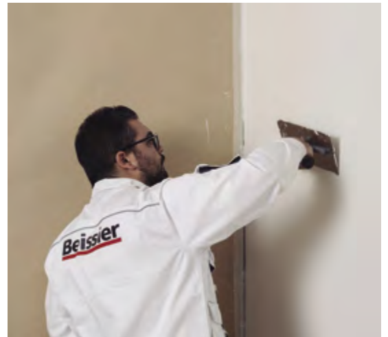
Terminar com uma camada de regularização com o mesmo Reboco Fino Interior BMB12002.
