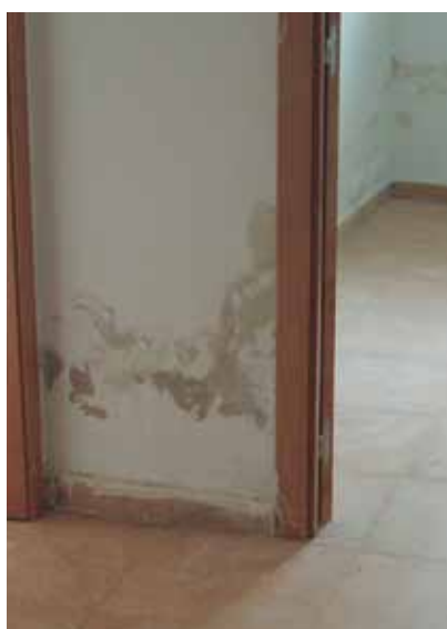
Humedad por capilaridad.
