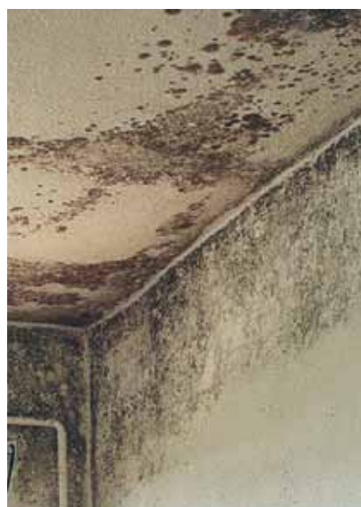
Condensación en paredes frías.
