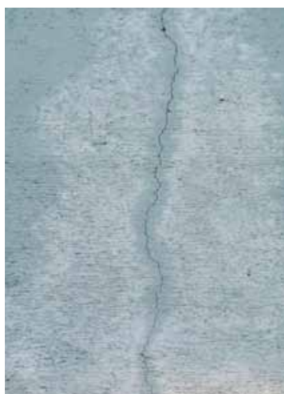
Filtraciones por grietas en el exterior.
