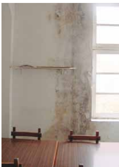
Humedad por capilaridad.
