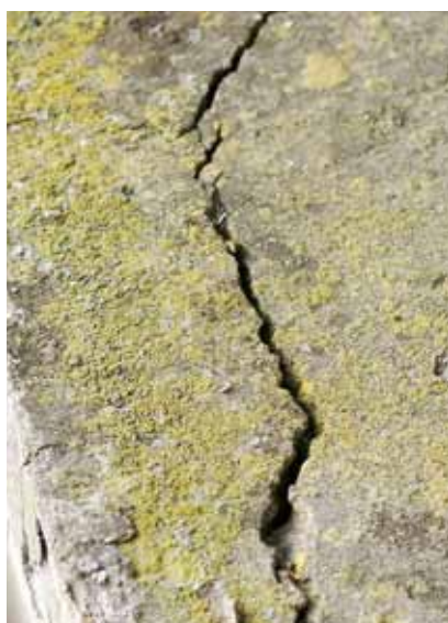
Filtraciones por grietas en el exterior.
